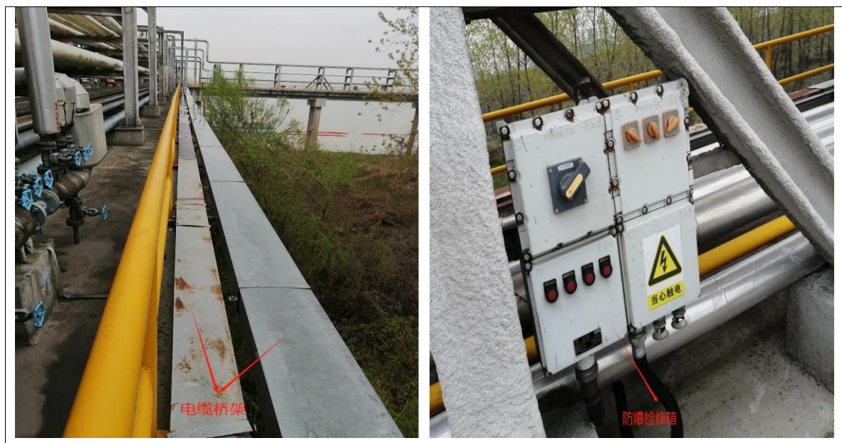
图 2.13.1-3 码头电缆桥架以及防爆检修箱
