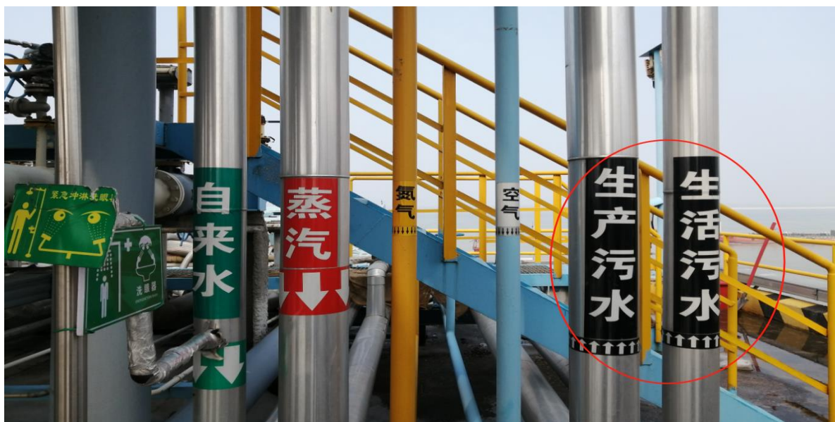
图 2.13.6-1 现场敷设的生产污水和生活污水管道
