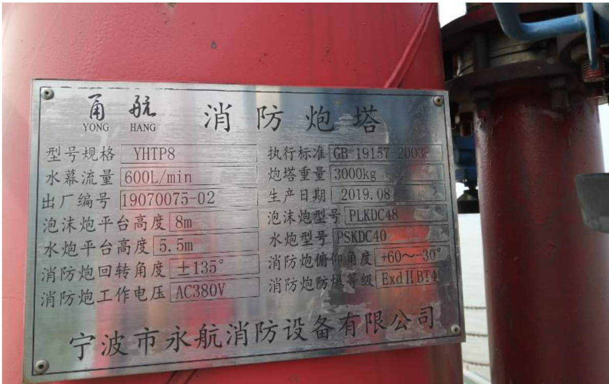
图 2.9-13 趸船上的消防炮塔
