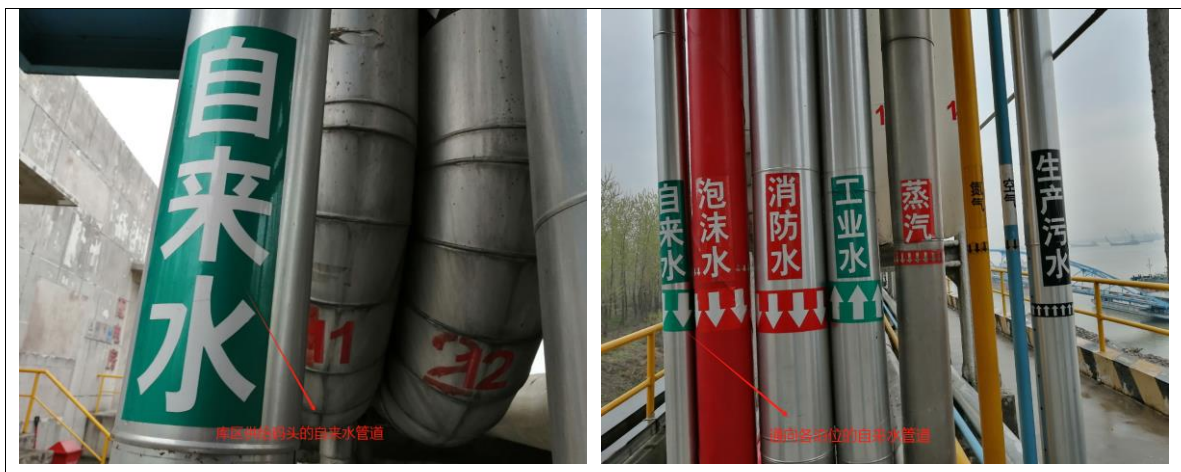
图 2.13.5-1 现场的自来水管道
