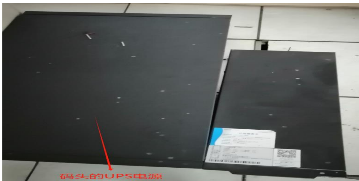
图 2.13.1-2 码头的 UPS 电源
