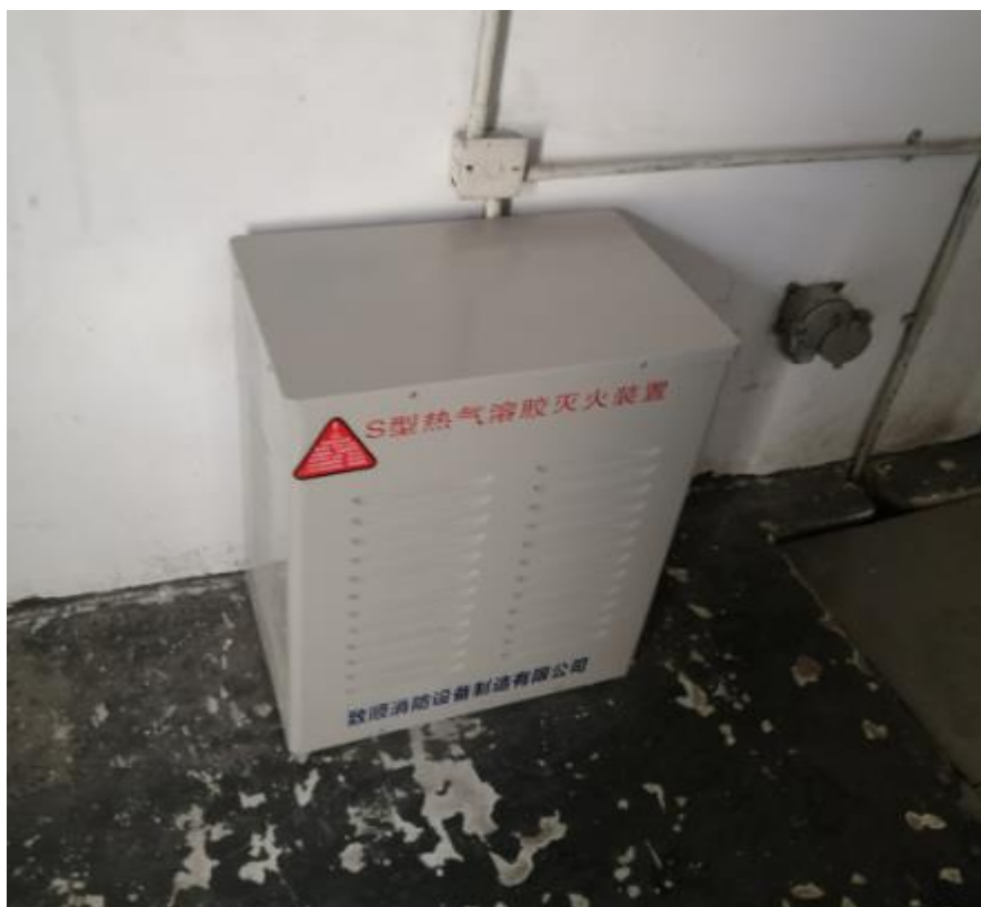
图 2.9-5 发电机房的 S 型热气溶胶灭火装置
