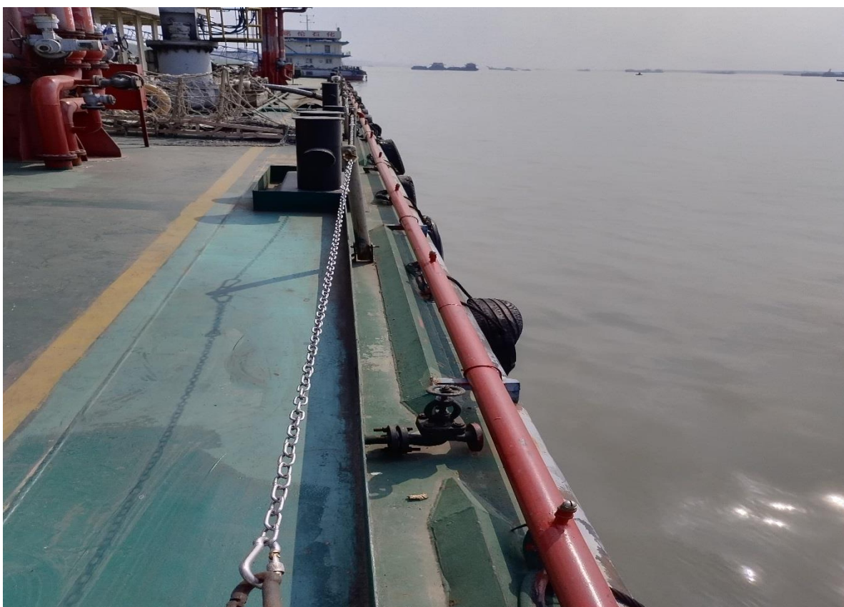
图 2.11-5 现场拍摄的 1#泊位趸船前沿设置的消防水幕
