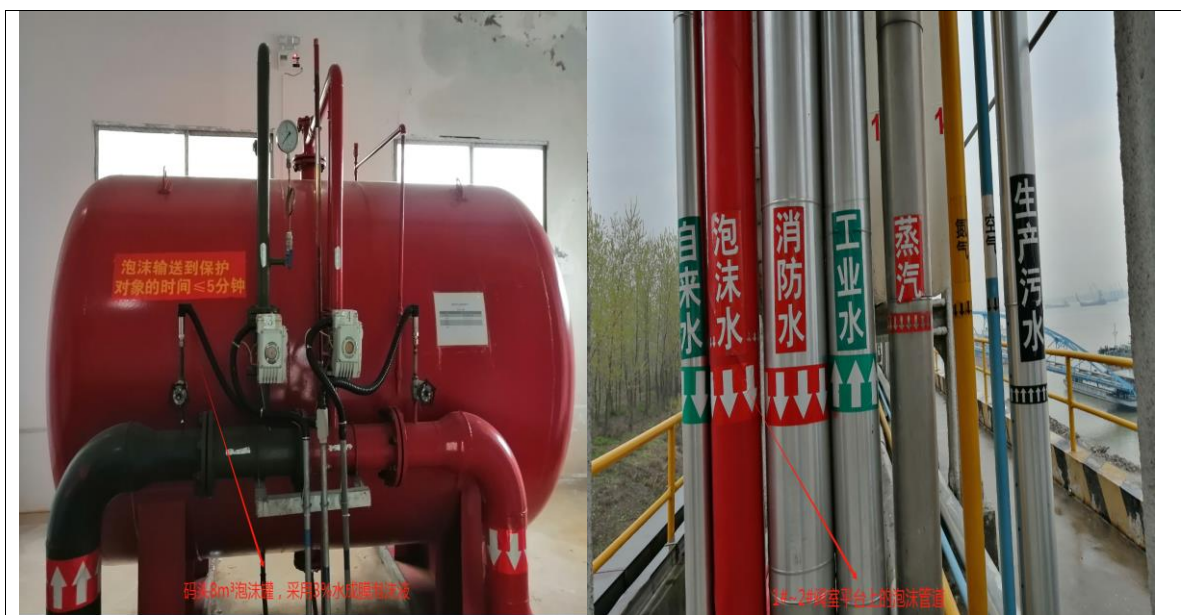
图 2.11-1 现场拍摄的泡沫罐及泡沫管道照片
