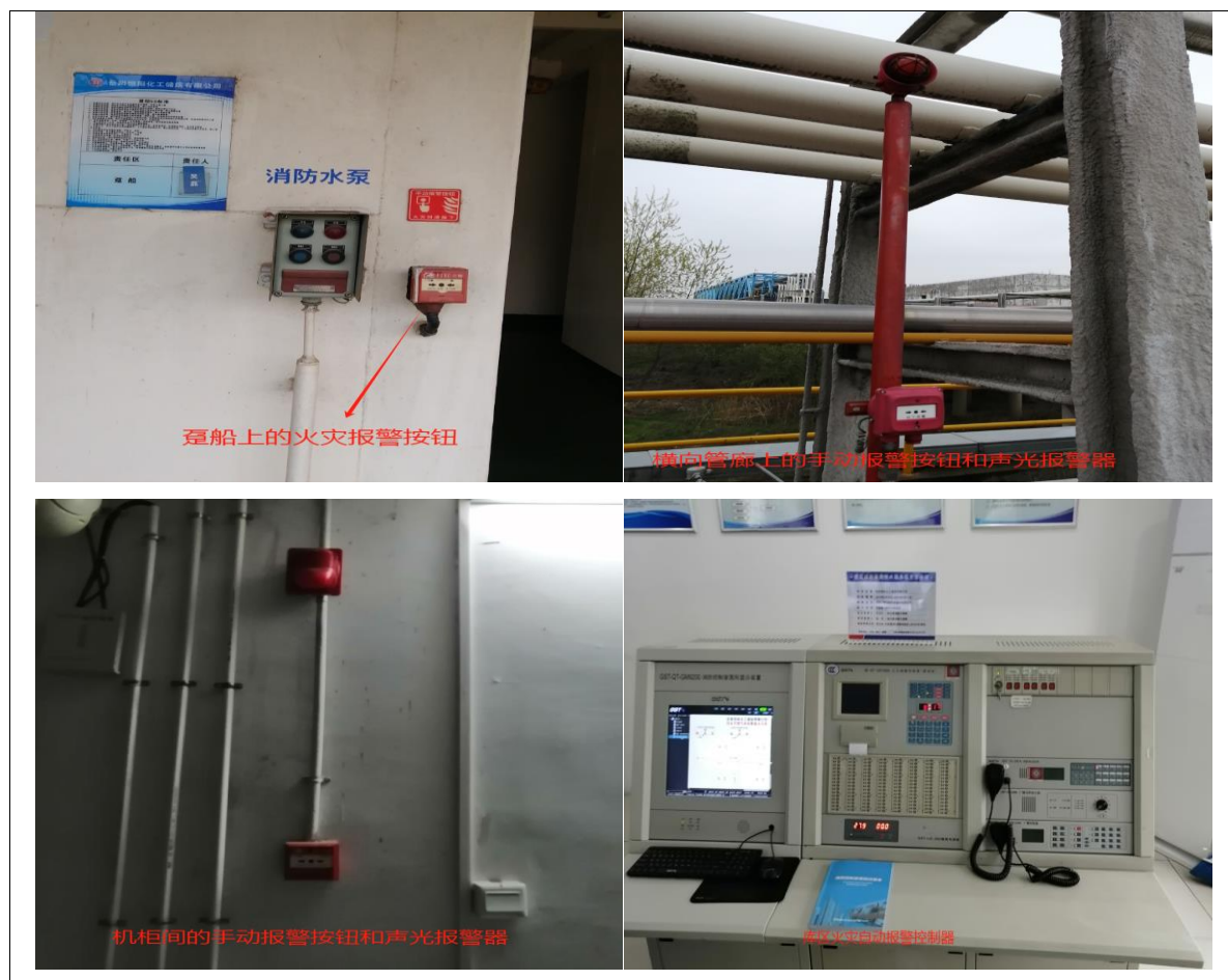
图 2.13.3-3 码头上部分消防控制系统照片
