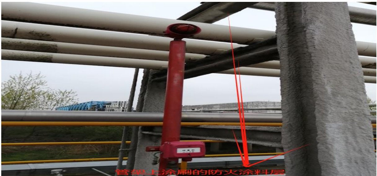
图 2.11-7 管架上涂刷的防火涂料
