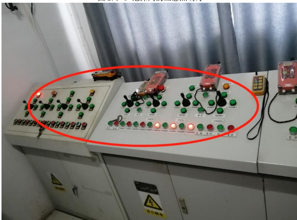
图 2.9-9 泡沫间旁的趸船消防炮塔控制器
