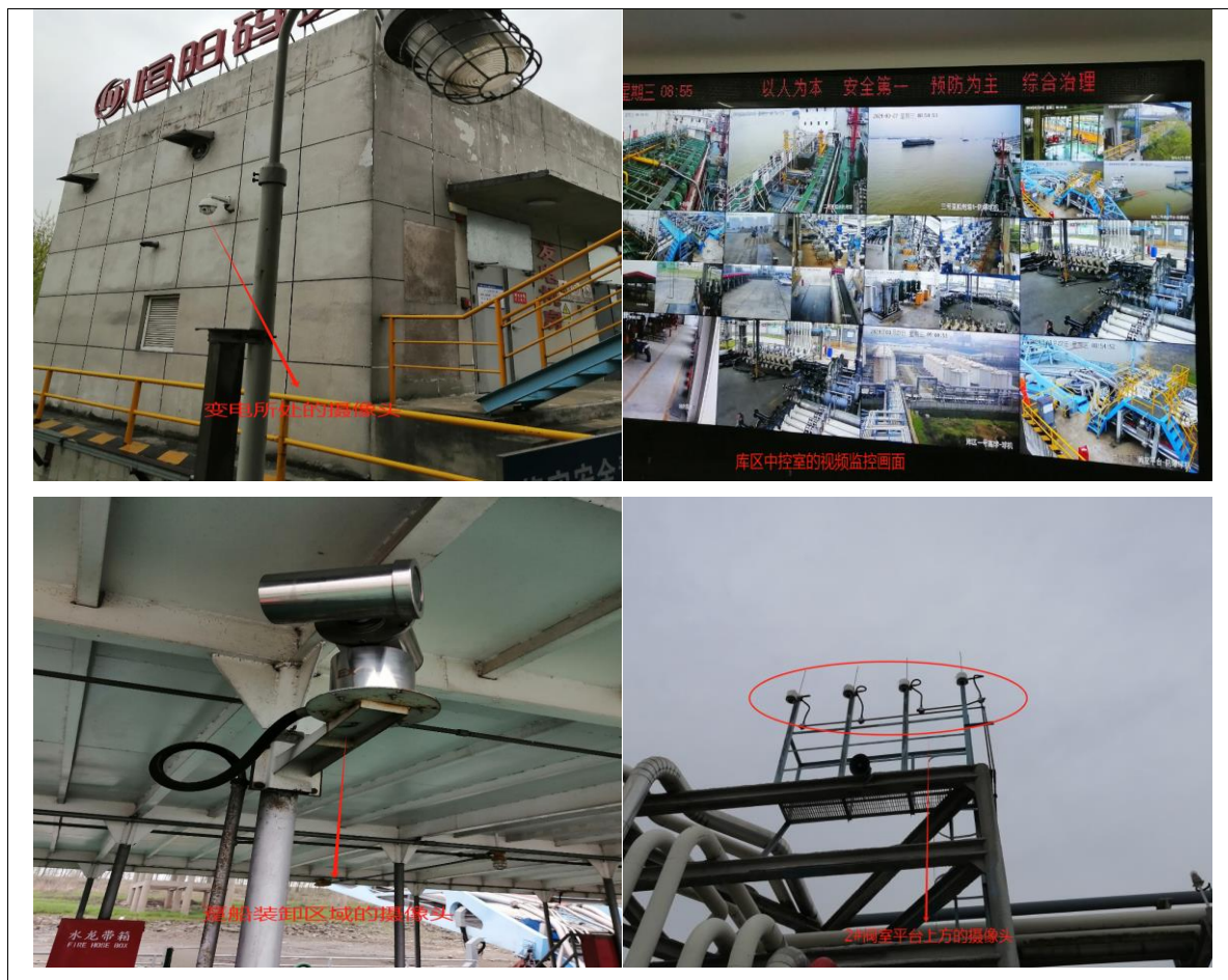
图 2.13.4-1 现场的视频监控系统相关照片
