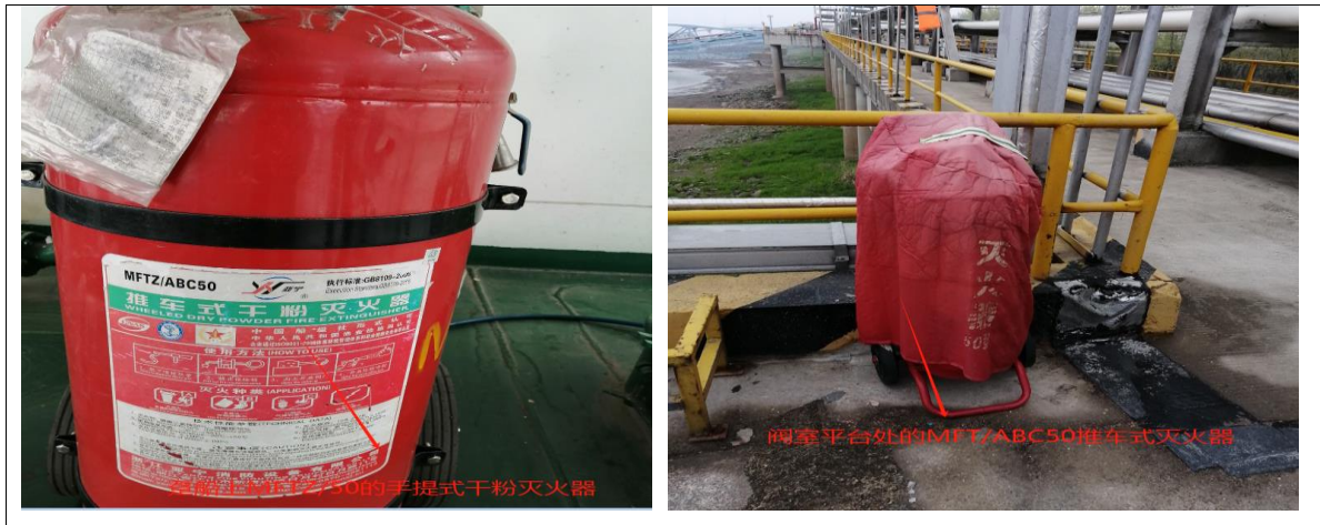
图 2.11-6 现场拍摄的灭火器材照片
