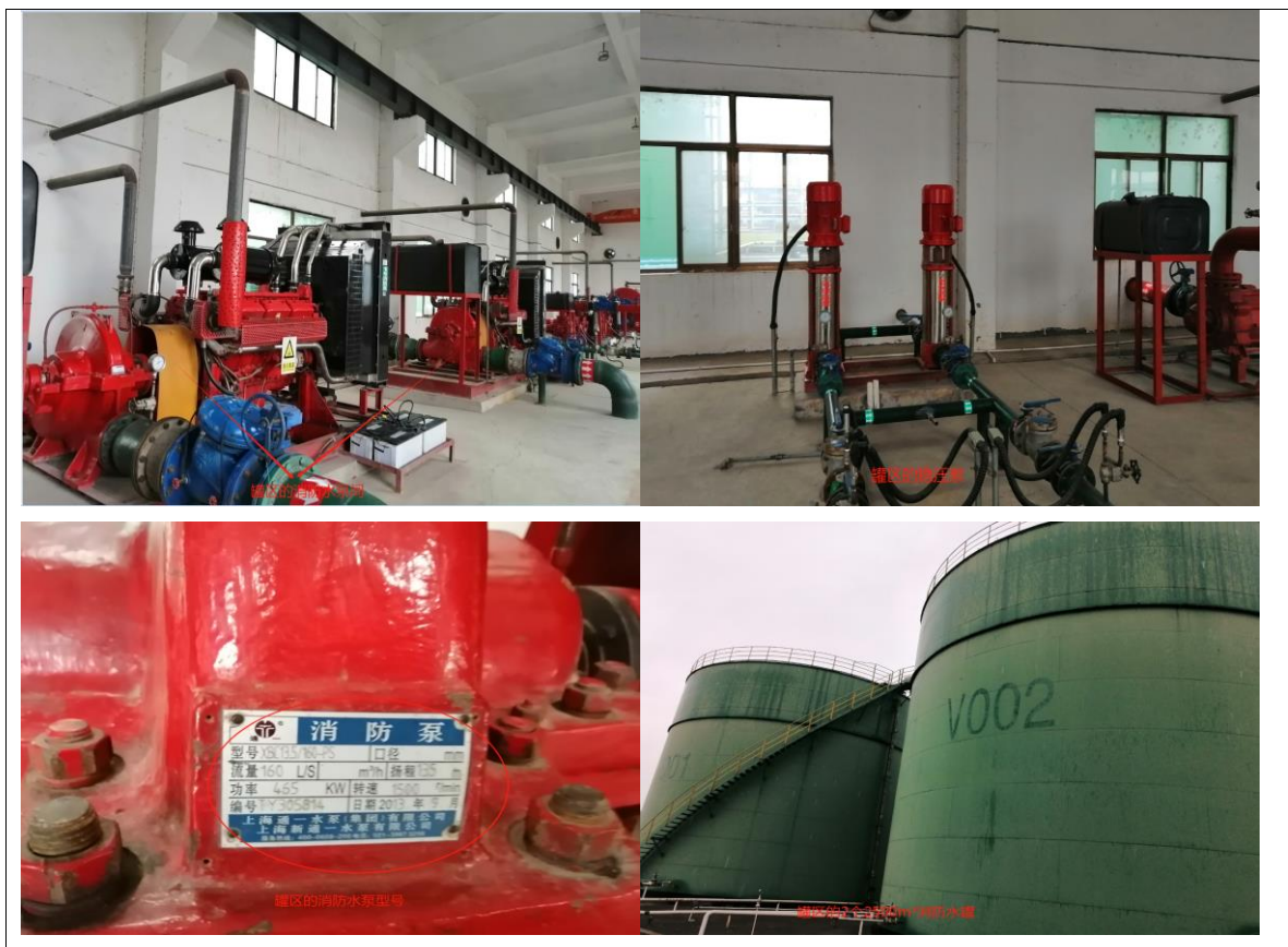
图 2.14-1 主要依托库区消防设施的情况
