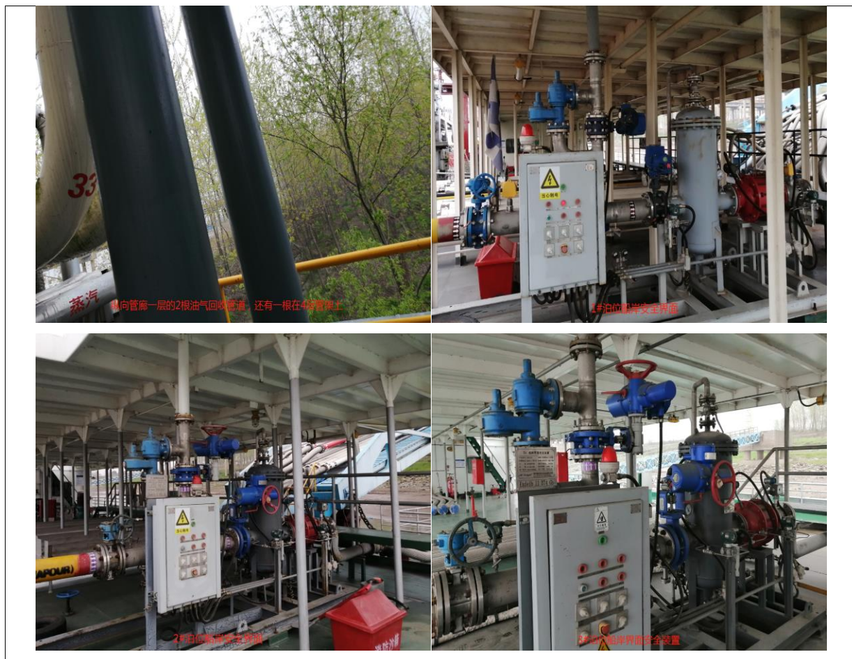
图 2.8.1-2 船岸界面安全装置以及油气回收管道
