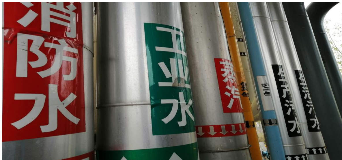
图 2.13.7-1 码头入口处的蒸汽、氮气和压缩空气管道
