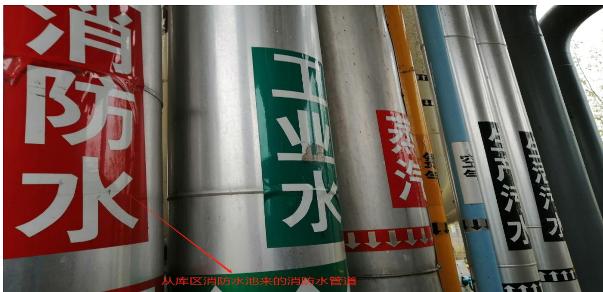
图 2.11-2 库区消防水管道
