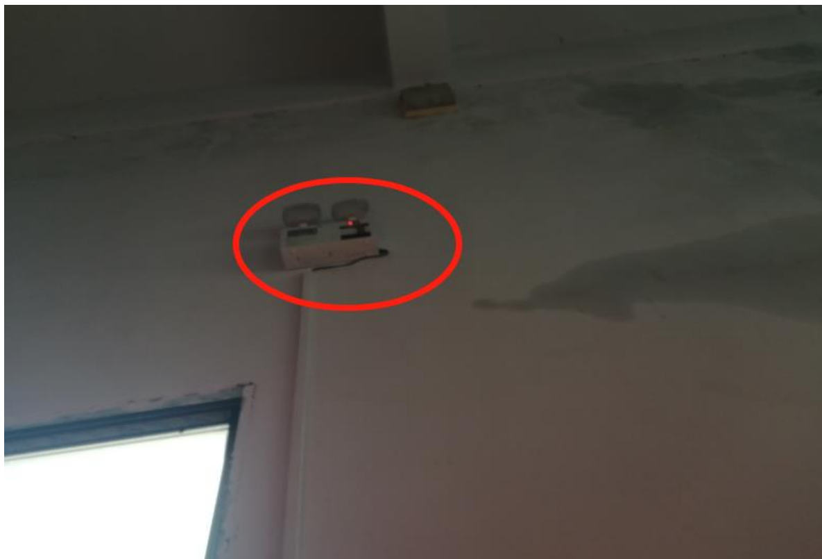
图 2.9-8 泡沫间的应急照明灯
