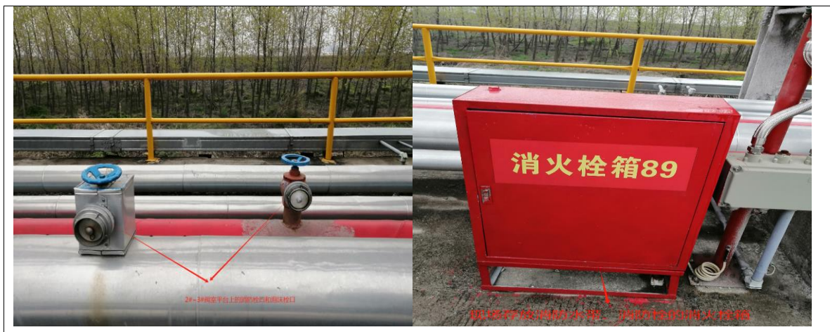
图 2.11-4 现场拍摄的消防栓口及消防箱照片
