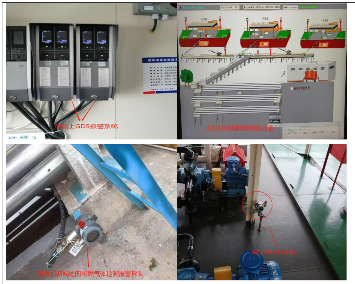
图 2.13.3-2 现场自控系统相关设备
