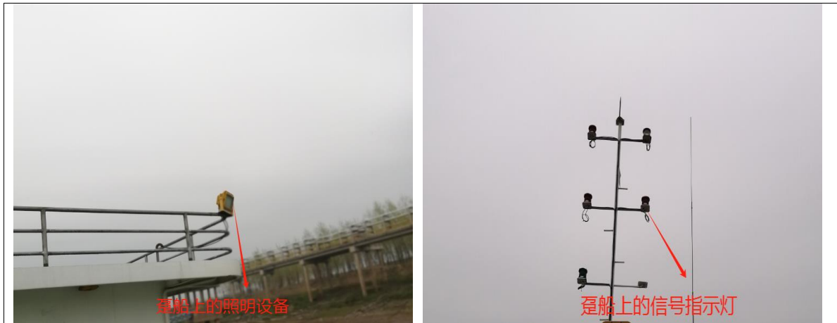
图 2.13.1-4 现场的照明设施
